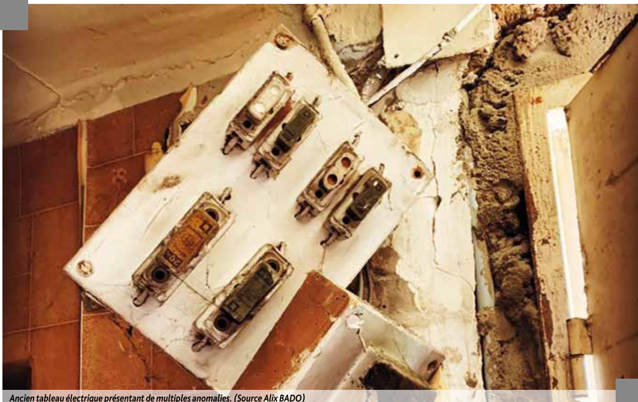
Ancien tableau électrique présentant de multiples anomalies. (Source Alix BADO)
