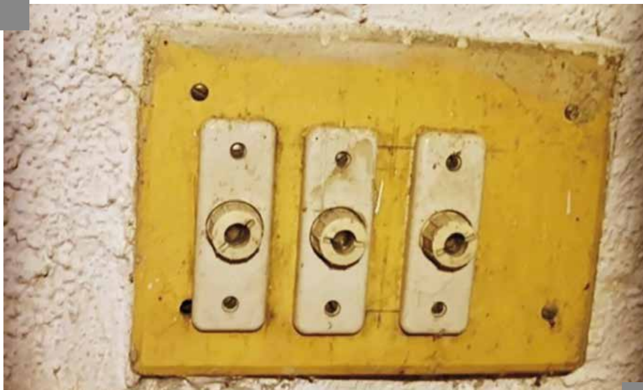
Fusibles à puits : risques d'accès aux parties actives (lors du remplacement du fusible), d'électrisation, voire d'électrocution et d'incendie. (Photo Alix BADO)
